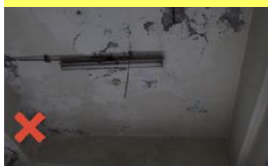
烹煮區天花板破損
