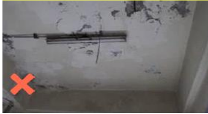
烹煮區天花板破損
