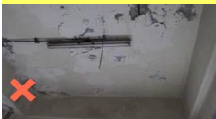
烹煮區天花板破損
